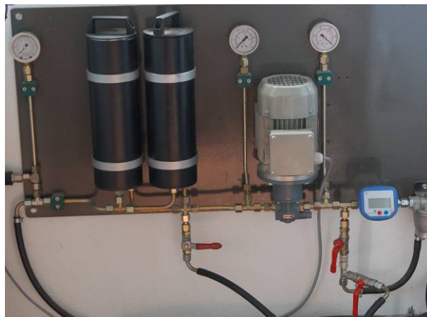
SMF-Filteranlage und SMF-Fördersystem
